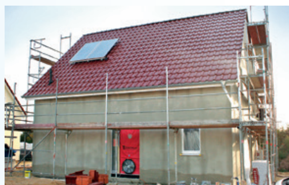
BlowerDoor Messung eines neu gebauten Einfamilienhauses
